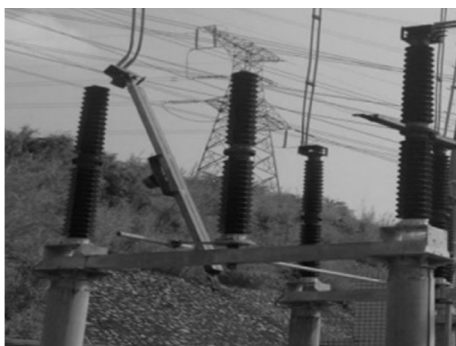
图1 220 kV三柱式隔离开关支柱绝缘子
