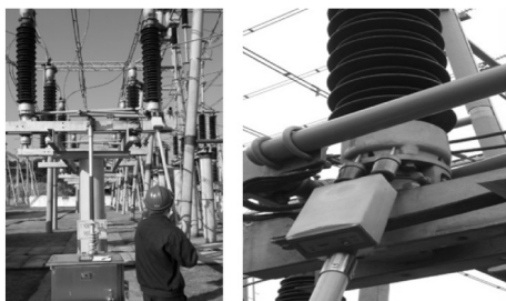
图8 瓷支柱绝缘子带电状态检测系统测试
